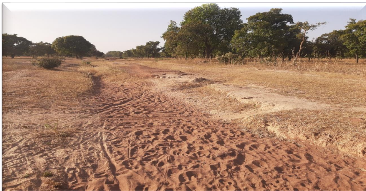
Photo 4: Etat de dégradation de la piste Kourouma-Kelworo
