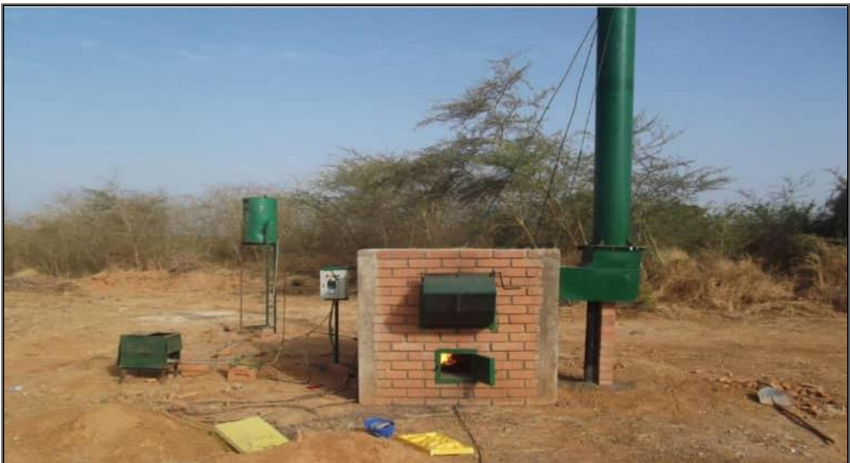
Photo 5 : Incinérateur modèle « Faso incinérateur »
