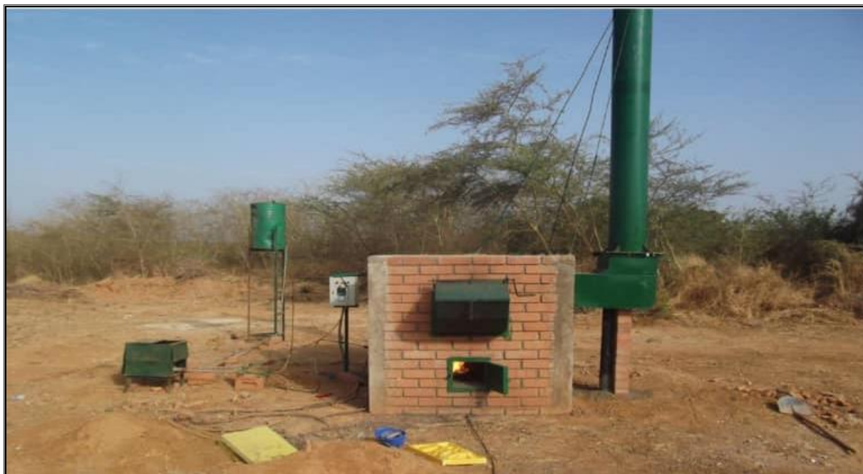
Photo 7 : Incinérateur modèle « Faso incinérateur »
