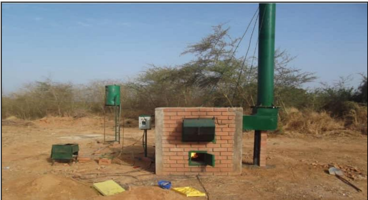
Photo 7 : Incinérateur modèle « Faso incinérateur »
