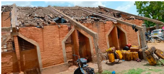
Bâtiment d'hébergement dégradé
